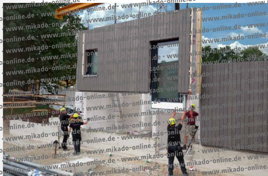
Vorgefertigte Wandelemente werden in einem Stück auf die Baustelle transportiert und konnten so zügig und sicher montiert werden.
