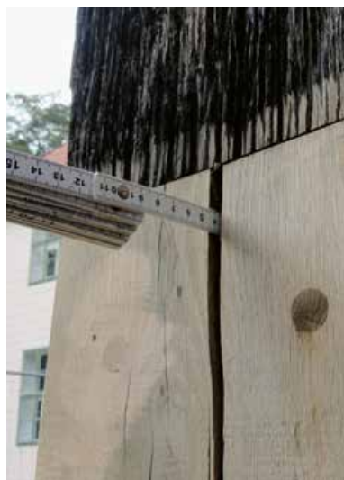
◀ Hier ist die Bohle gerissen
